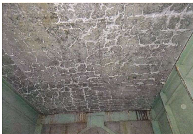
着工前のクラック状態
