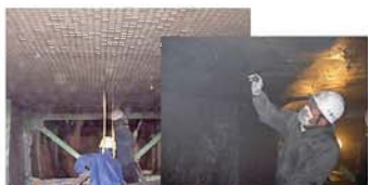
写真5. ホゼン材（ポリマーセメントモルタル）を吹付け増厚する様子
