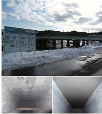
写真9. 施工事例 (和田大橋: PC桁橋) 上: 橋外観 左下: 施工前 右下: 施工後
