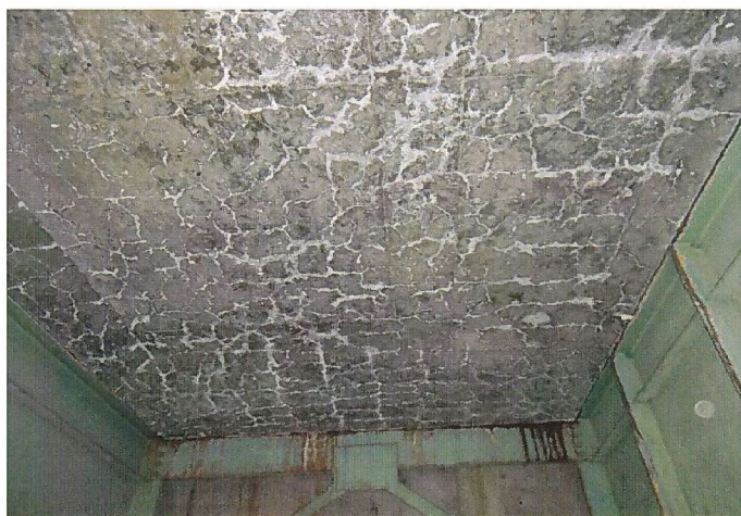
着工前のクラック状態
